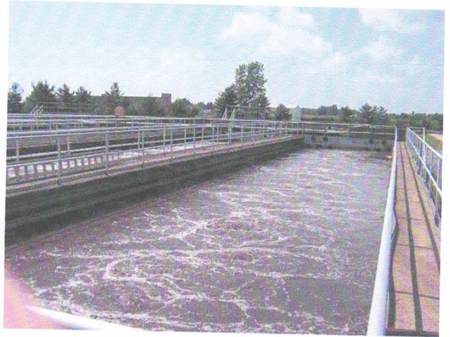
บ่อบำบัดน้ำเสีย
