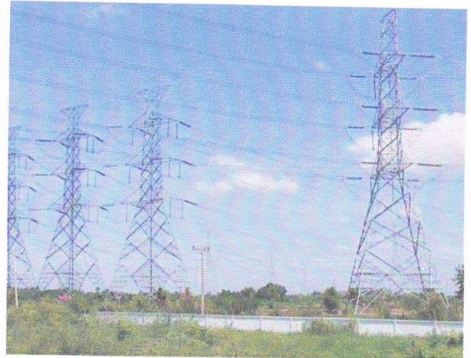
เสาไฟฟ้า
